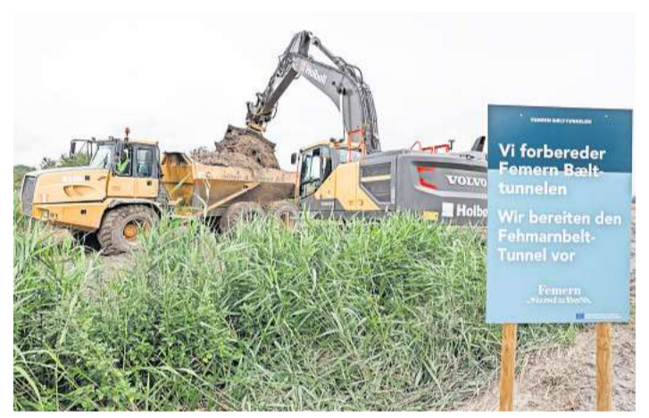
Die Vorbereitungsarbeiten auf deutscher Seite starteten im Dezember 2020. Erst jetzt geht es richtig los.
