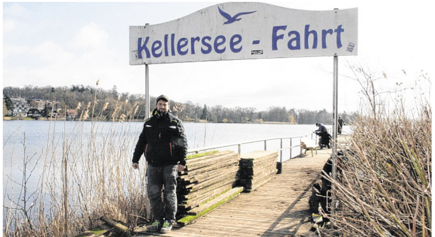
Hinnerk Frahm und seine Mitarbeiter erneuern den Steg am Ende der Janusallee. Andere Reparaturen, die technisch nicht unbedingt notwendig waren, mussten im vergangenen Jahr aber zurückstehen.
