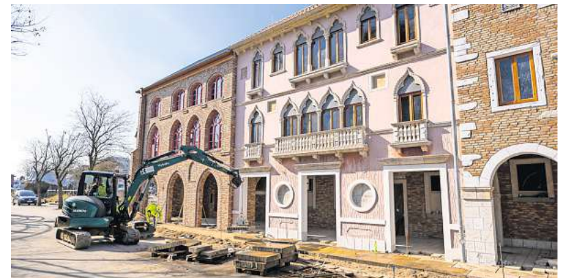
Viele Fassaden am Eingangsbereich des Freizeitparks sind bereits so gut wie fertiggestellt.
